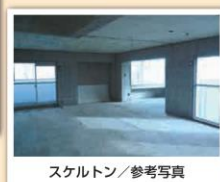
マンションリフォーム新築そっくりさん スケルトンリフォーム開発
